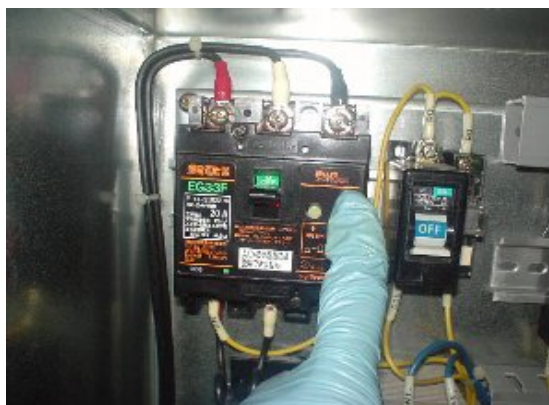
漏電ブレーカー作動確認
