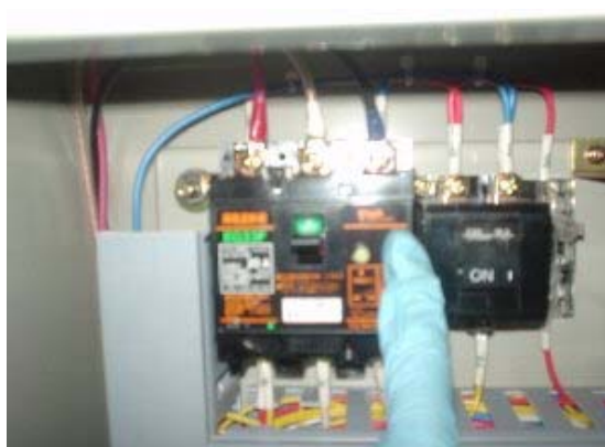
漏電ブレーカー作動確認
