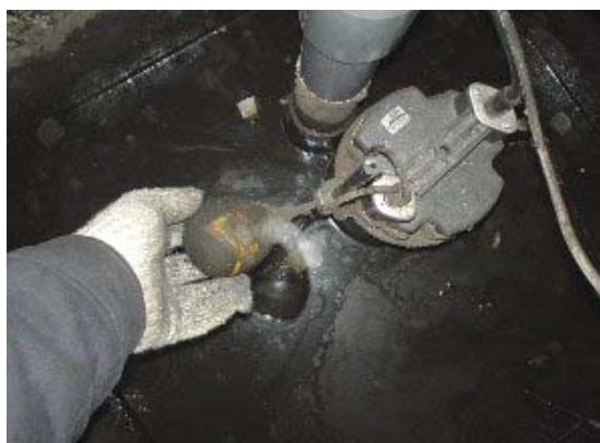
排水ポンプ作動確認
