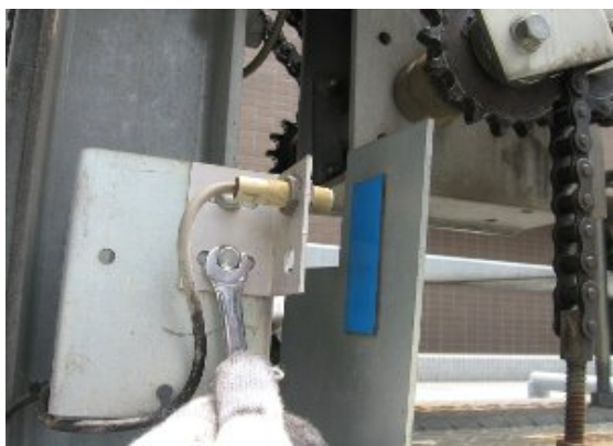
近接スイッチ取付けステー増し締め
