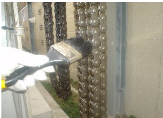
吊りチェーンにオイル給油
